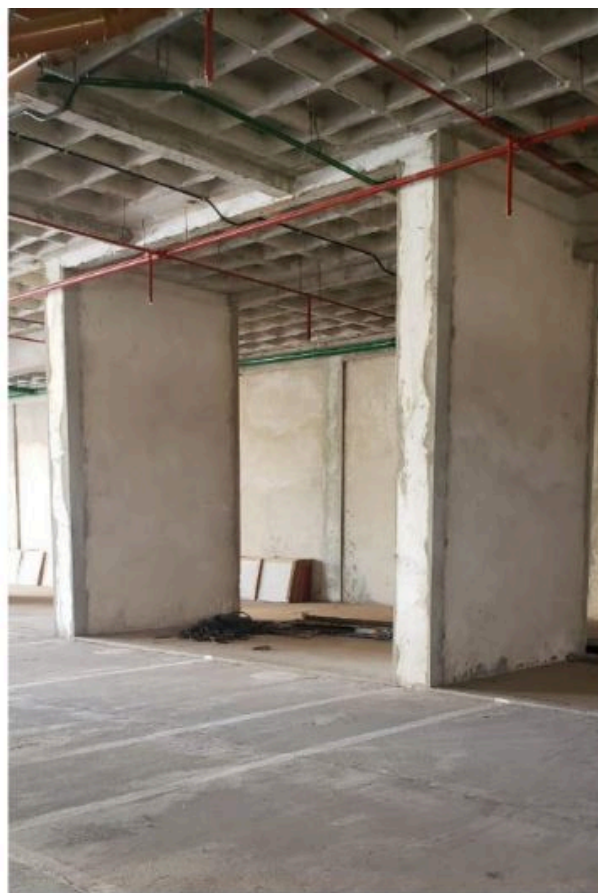
Imagem 15: Pavimento térreo, vista parcial lateral esquerda do ambiente. O espaço ainda não possui instalação de pisos e forro.
